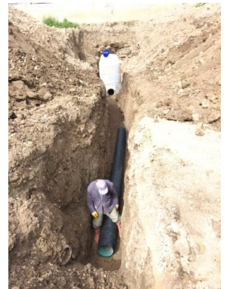
Çakallar Mah. Kanalizasyon Hattı
