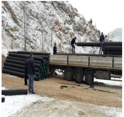
Kullanılan Boru Malzemesi
