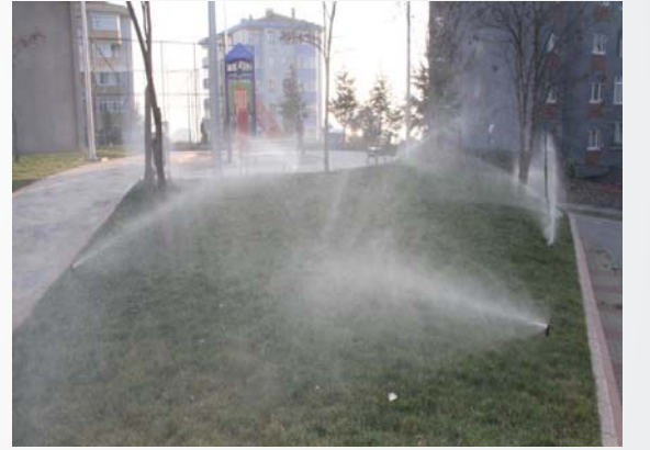
Uğur Mumcu Mahallesi Leylak Sokak Yanı Parkı Yağmurlama Sulama Sistemi
