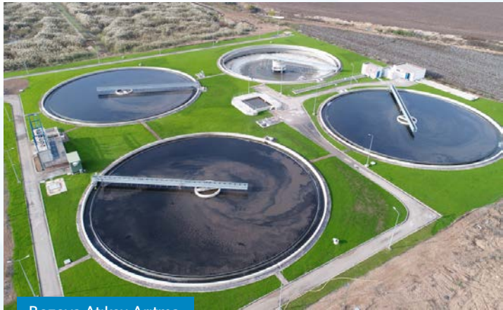
Bozova Atıksu Arıtma
