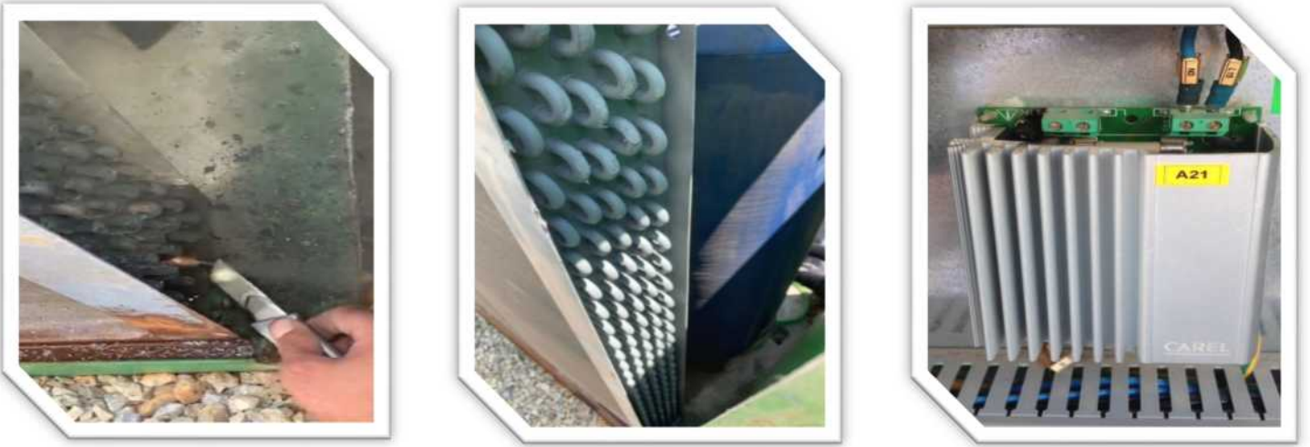
Karaduvar Atıksu Arıtma Tesisi Chiller Temini
