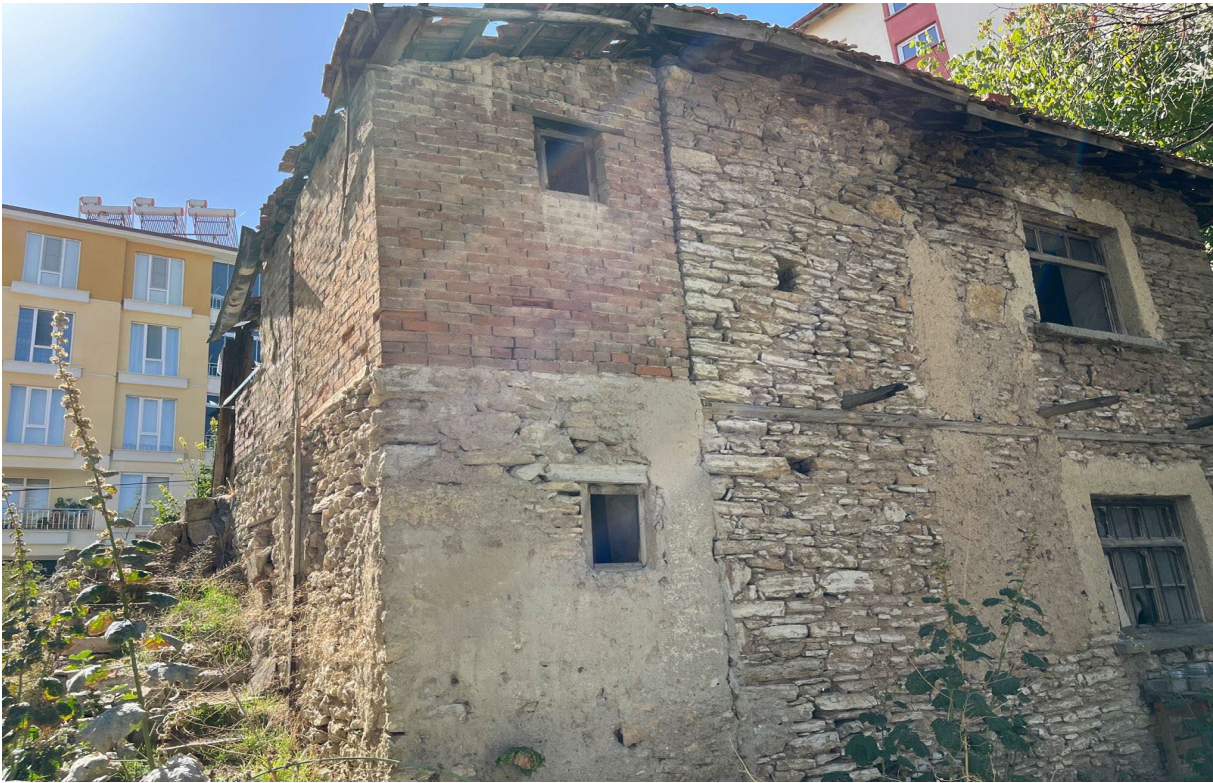
Resim-8 Metruk Yapı Örneği
