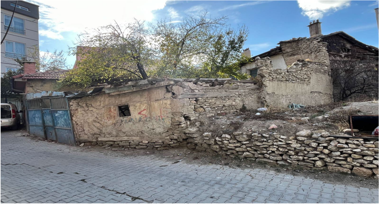
Resim-7 Metruk Yapı Örneği
