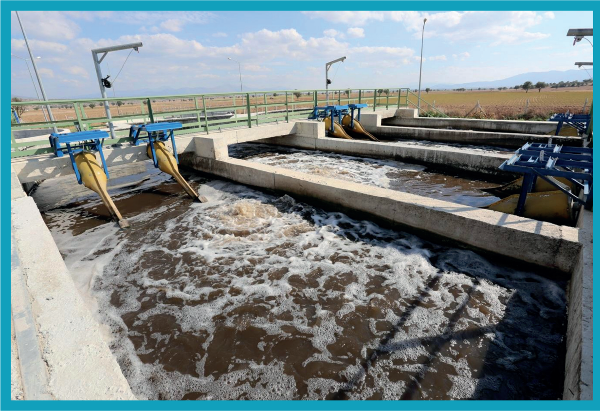
Serinhisar Atıksu Arıtma Tesisi
