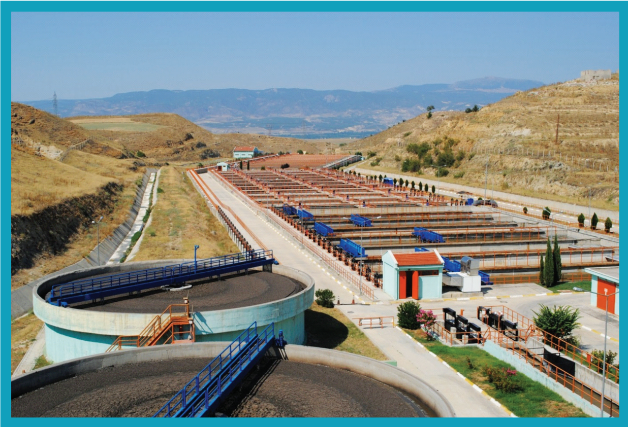
Merkez Atıksu Arıtma Tesisi
