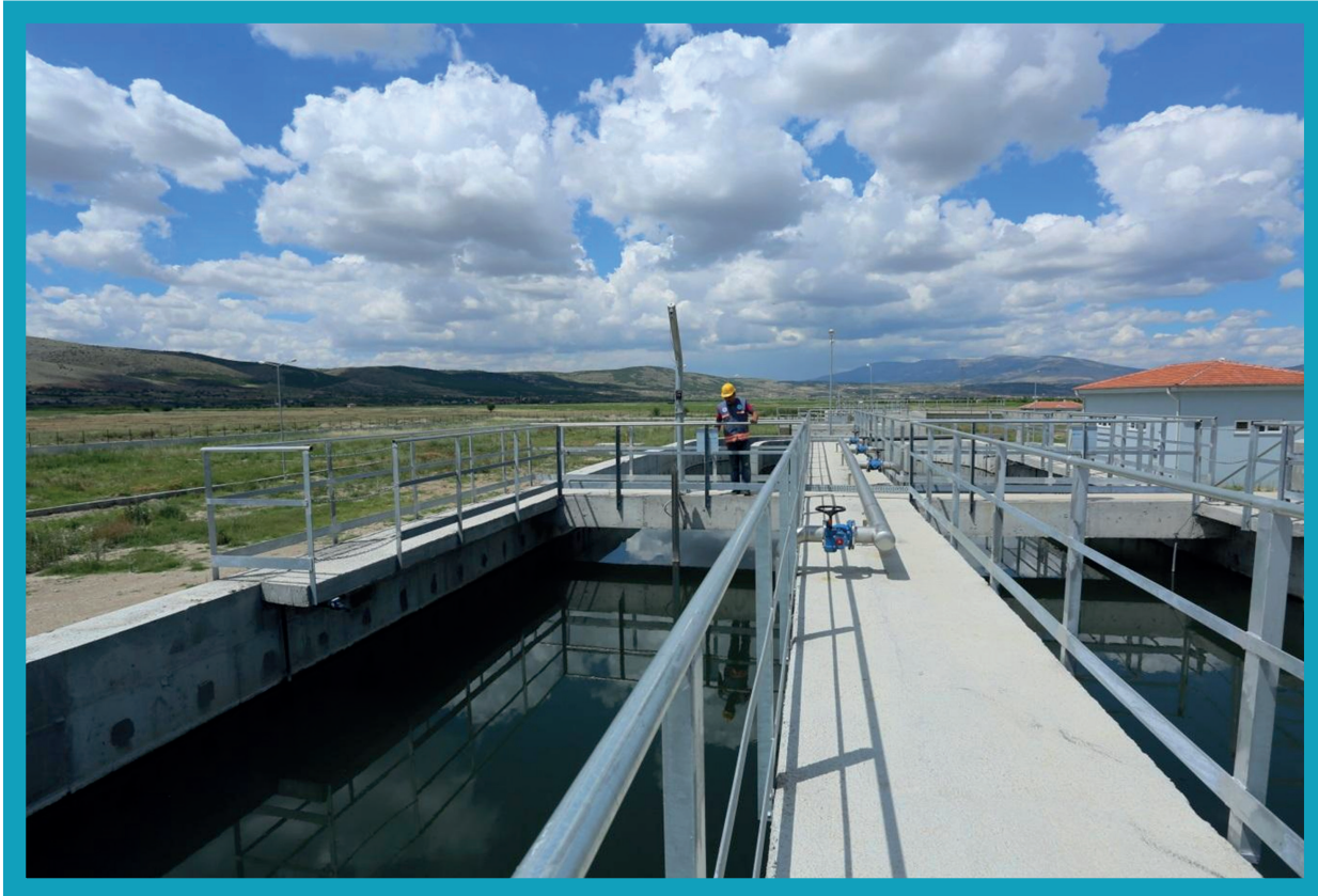
Çivril Atıksu Arıtma Tesisi
