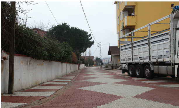
Asfaltı bozuk yerlerde asfalt yerine taş kaplama
