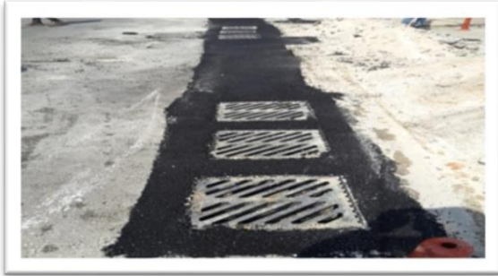
Bahçeleriçi Mah. Yağmur suyu
