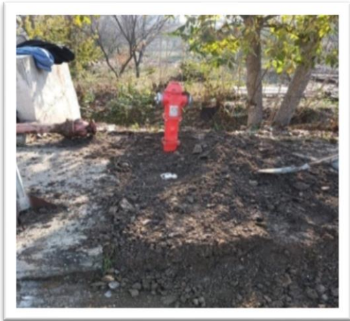
Yazıbağları Tugay önü yangın vanası
