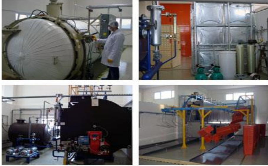
Tıbbi Atık Sterilizasyon Tesisi ve Otoklav Sistemi
