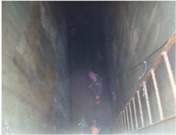
(Kanalizasyon terfi merkezi kontrolü)
