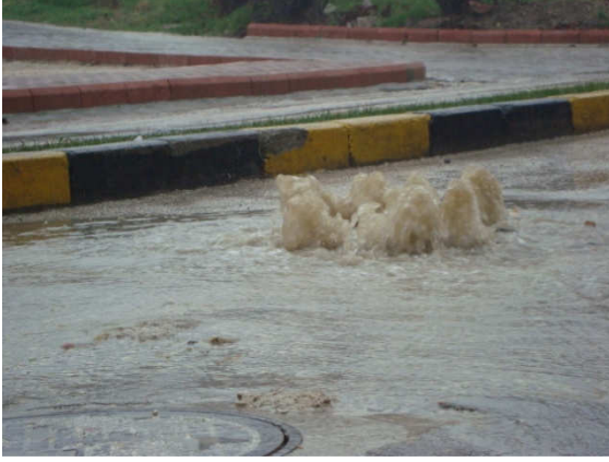
(Yağmur suyu baca taşkını)
