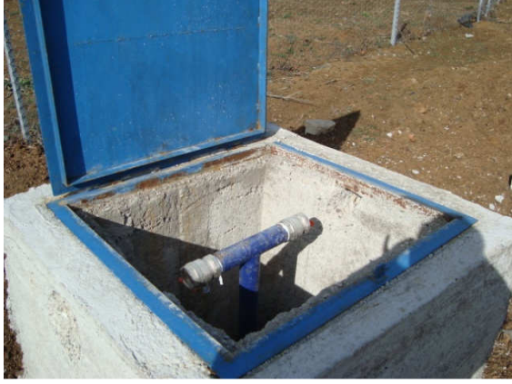
(İçme suyu vana kontrolü)
