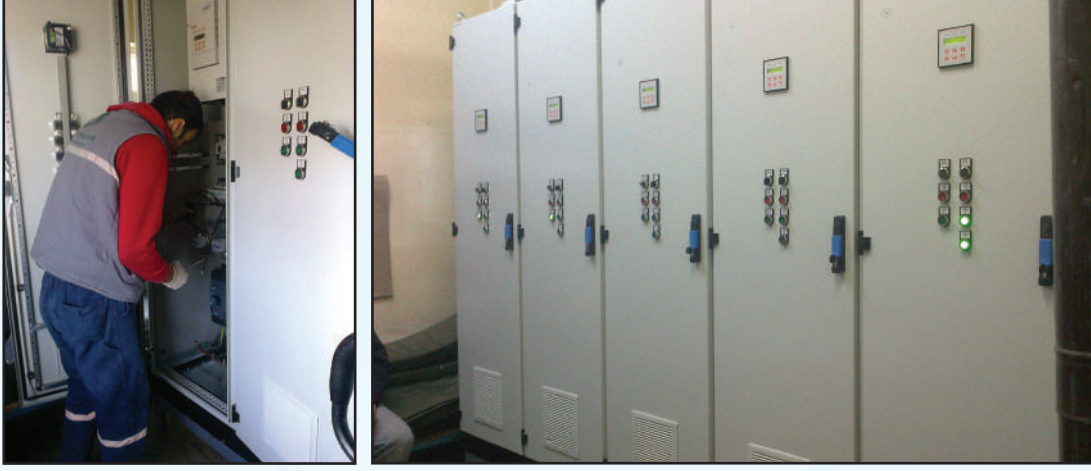
Beyşehir SCADA Montajı Tamamlanan Panoları
