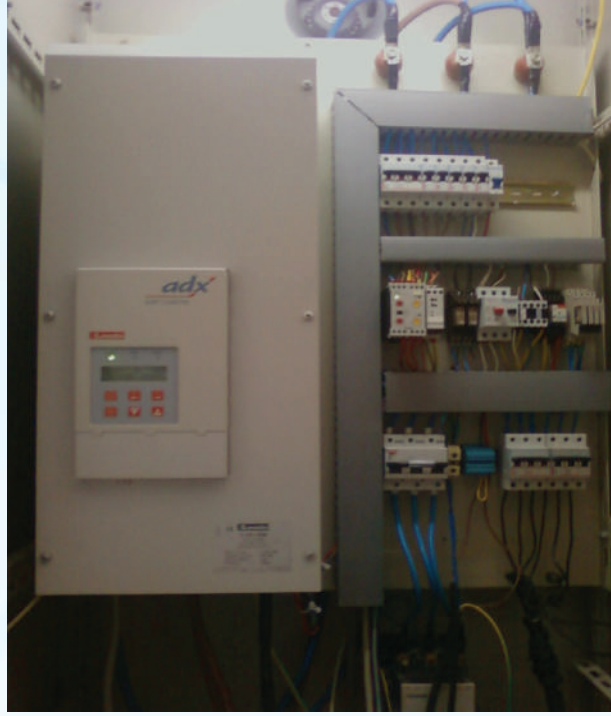
Akyokuş Arıtma Terfi İstasyonu Soft Starter Panosu
