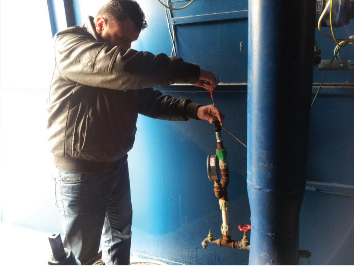
Yenilenen Basınç Transmitteri Montajı
