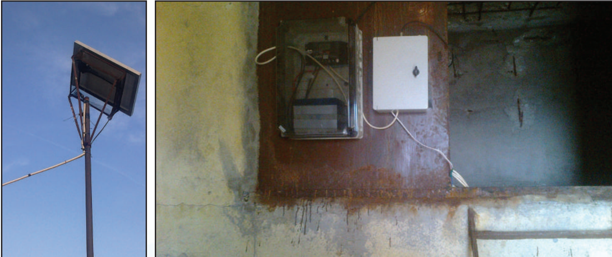
Çeşmeli Sebil Güneş Paneli ve Telemetri Panosu
