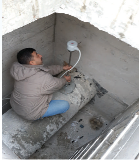
Akyokuş Arıtma Tesisleri Dere Bölgesi Macar Kanalı Debimetre
