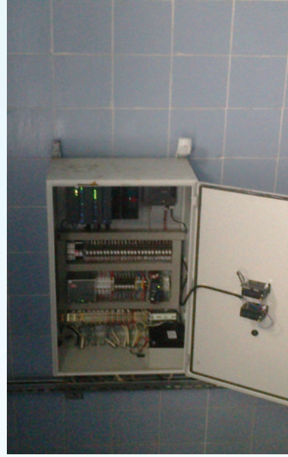
Çayırbağı Deposu ve SCADA Panosu
