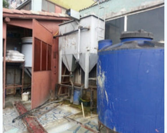
Şekil 4. Atıksu arıtma tesisi yağ tutucu ünitesi
