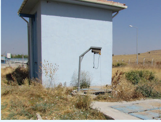
Terfi merkezi eski hali
