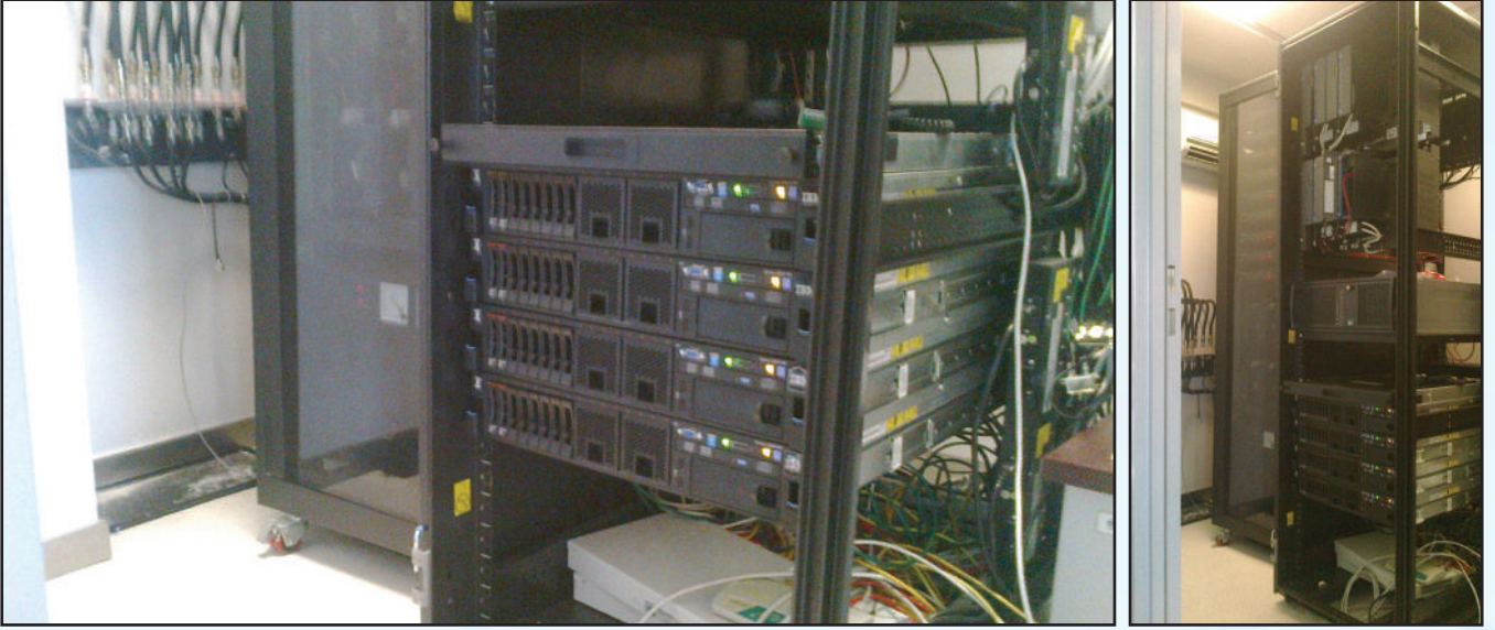
Merkez SCADA Sisteminde Yeni Server ve Gateway Cihazları
