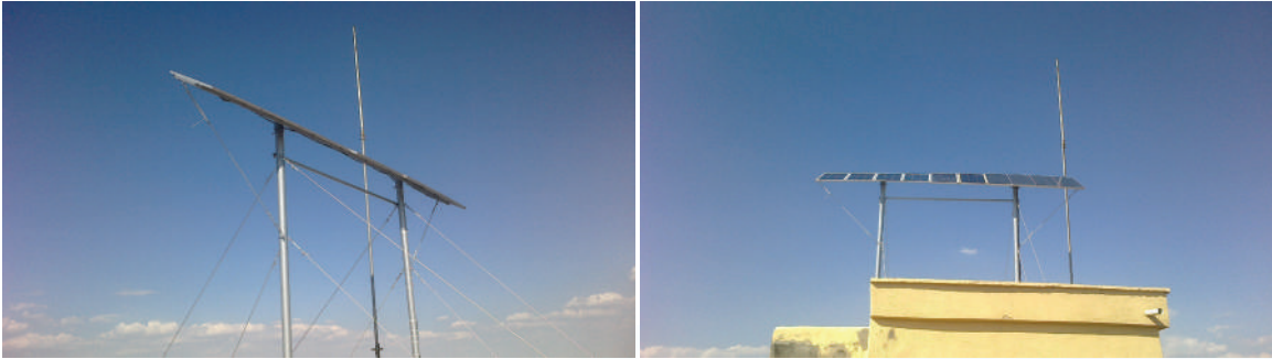
Tesislerimizde kullanılan güneş panelleri
