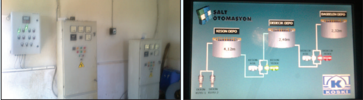
Beyşehir Kayabaşı Montajı Tamamlanan Telemetri ve Saha İzleme Paneli
