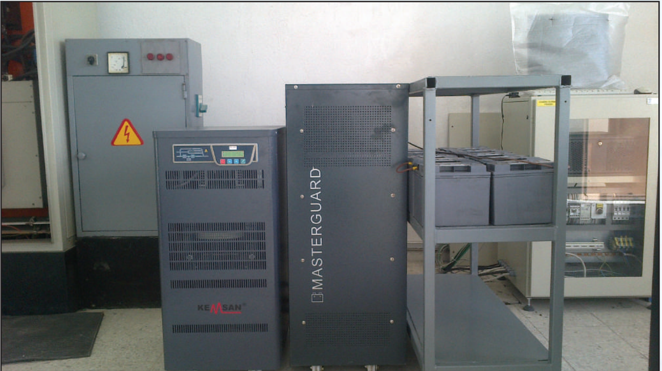
Yazır Pompa İstasyonu Yenilenen Kesintisiz Güç Kaynağı
