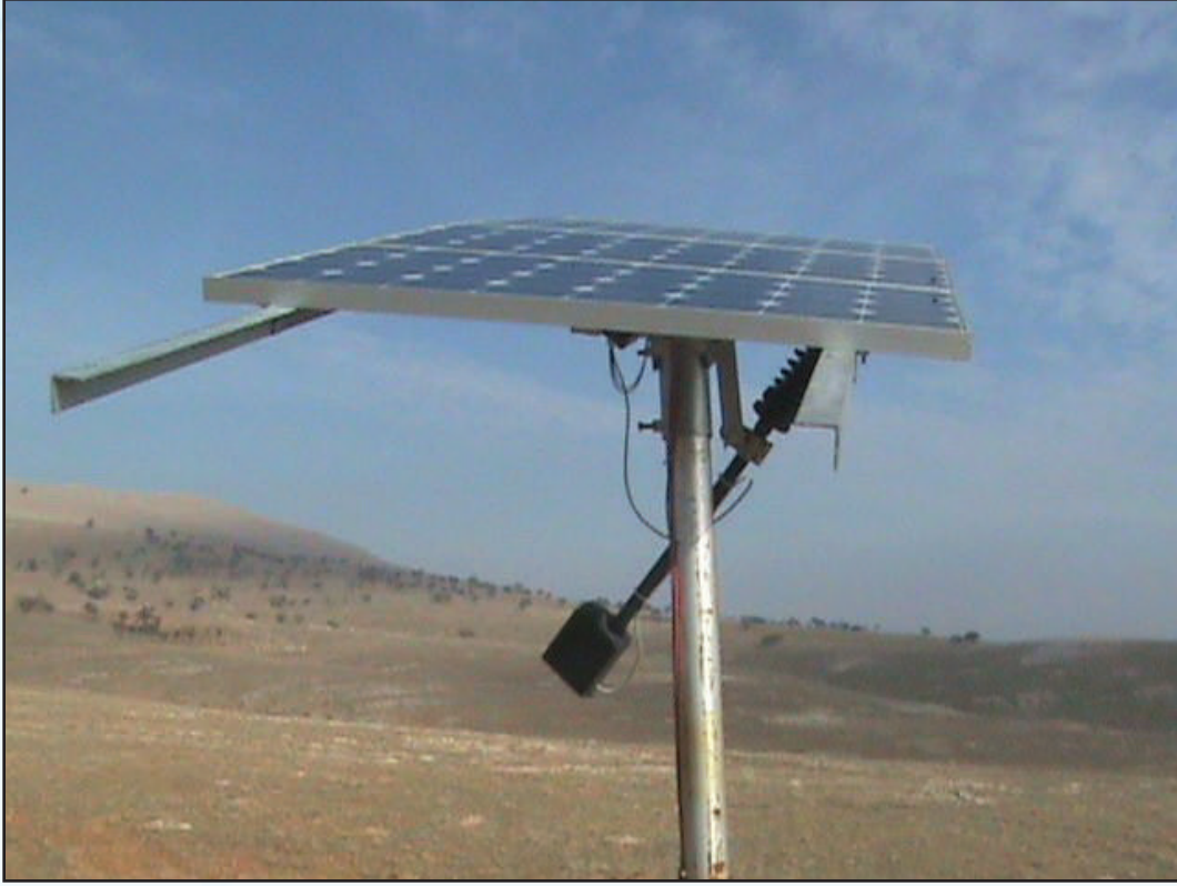
Karadiğın Kaynak Terfi İstasyonu 150 Watt Güneş Paneli
