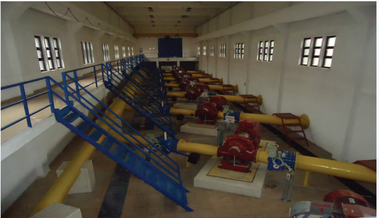
Pompa istasyonundan bir görünüm.
