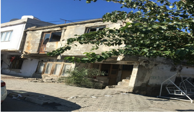
• Gürsel Mahallesinde bulunan metruk bina
