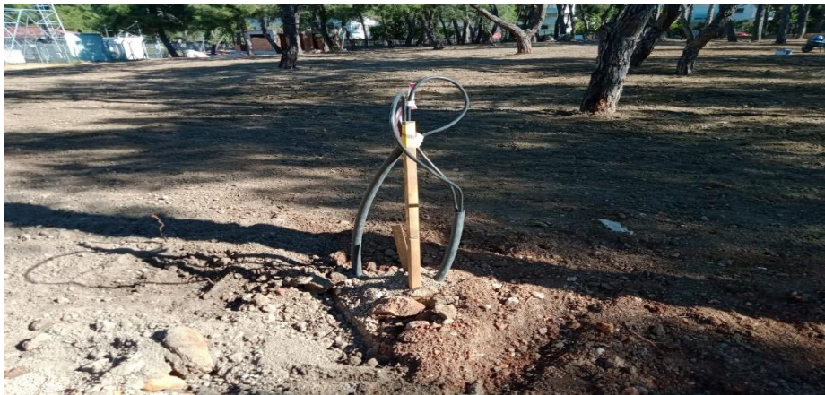
Resim 4 - Sisteme entegre edilmemiş yer altı kablolama
