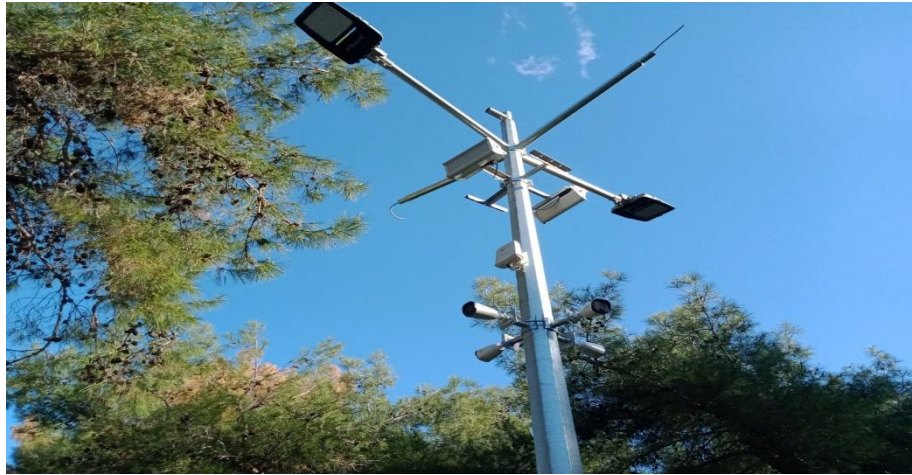
Resim 5 - Aydınlatma-İletişim Entegre Sistemi (Güneş paneli montajı yapılmamış)
