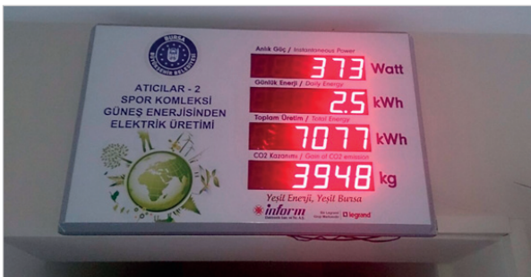
Batı AAT Güneş Enerjisi Sistemi
