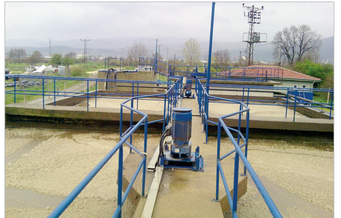
Çalı Atık Su Arıtma Tesisi
