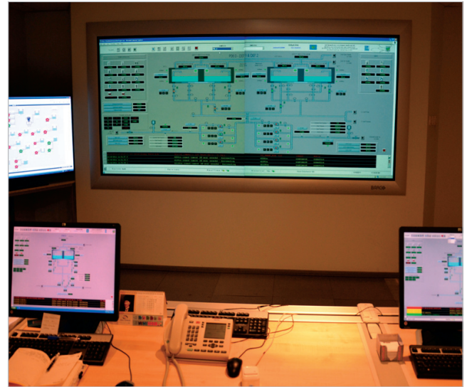
Scada Kontrol Merkezi
