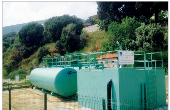
Narlı Paket Atık Su Arıtma Tesisleri
