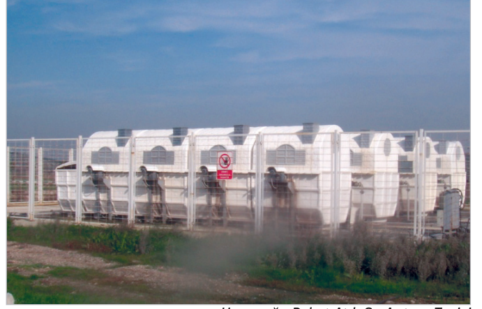
Hasanağa Paket Atık Su Arıtma Tesisi
