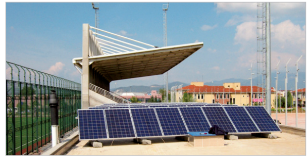
Batı AAT Güneş Enerjisi Sistemi
