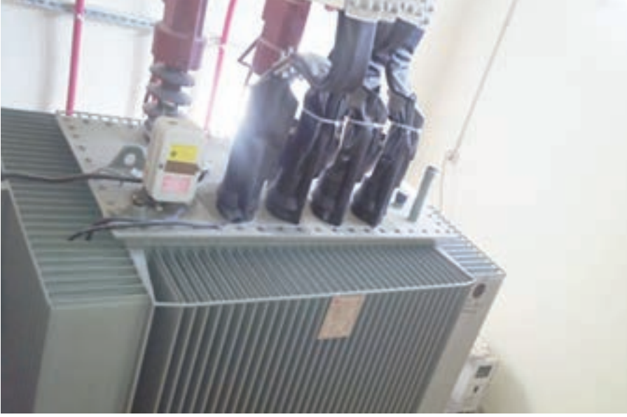
Resim 5. 1600 kVA Paralel trafo bağlantısı
