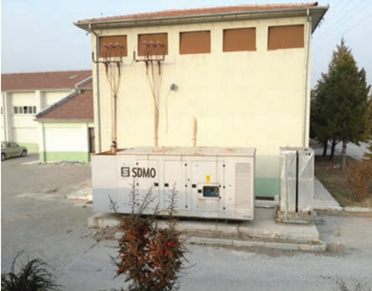
Hasanköy Pompa İstasyonu, Jeneratör
