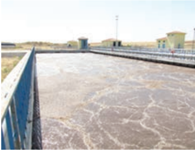
Resim 13. Kulu Atıksu Arıtma Tesisi
