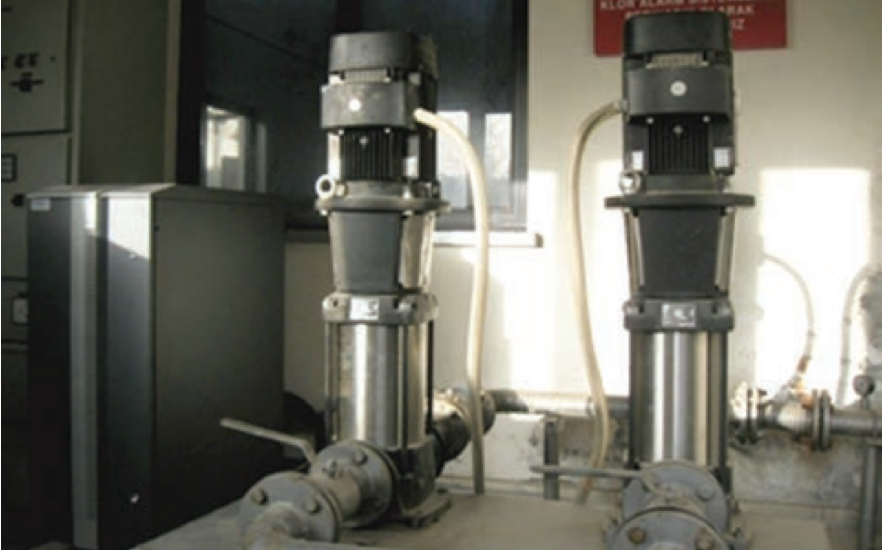
Buster pompaları ve 20kVA kesintisiz güç kaynağı
