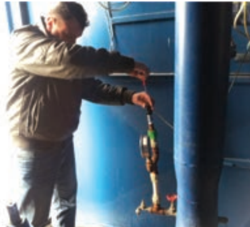
Yenilenen Basınç Transmitteri Montajı
