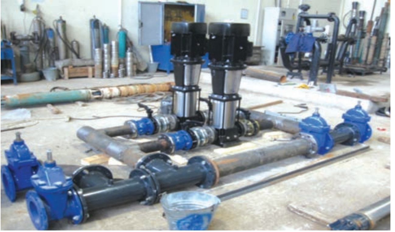
Sille Terfi Merkezinin atölyedeki montajlı hali
