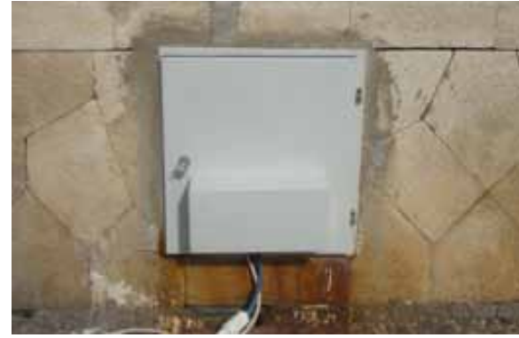
Elektrik Sayaçları ve Panoları (Yeni)
