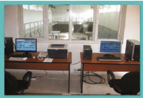
Resim:22 Alo Pompa İstasyonu Kumanda Odası
