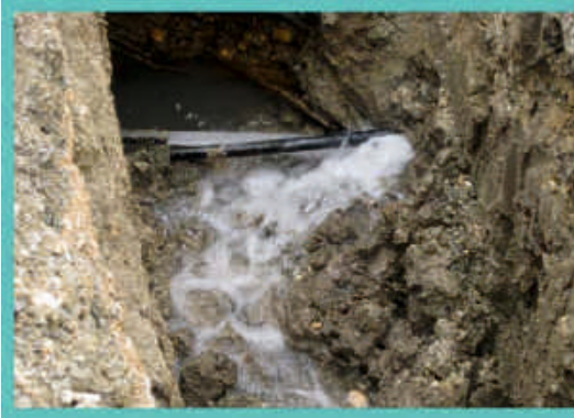
Resim:5 Pvc İçme Suyu Boru Arızası
