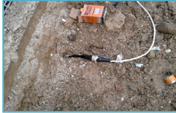
Kopuk elektrik bana branjman kablosu bağlantısı
