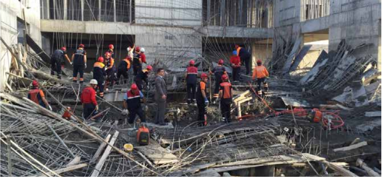
Balıkesir Üniversitesi İnşaat Göçüğü Kurtarma Çalışması
