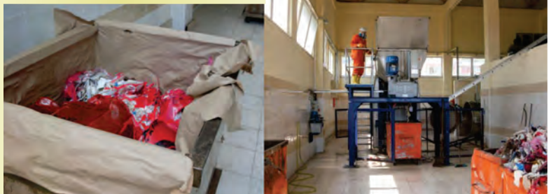
Resim: Tıbbi Atık Sterilizasyon Tesisi Binası, Sterilizasyon Ünitesi, Parçalama Ünitesi
