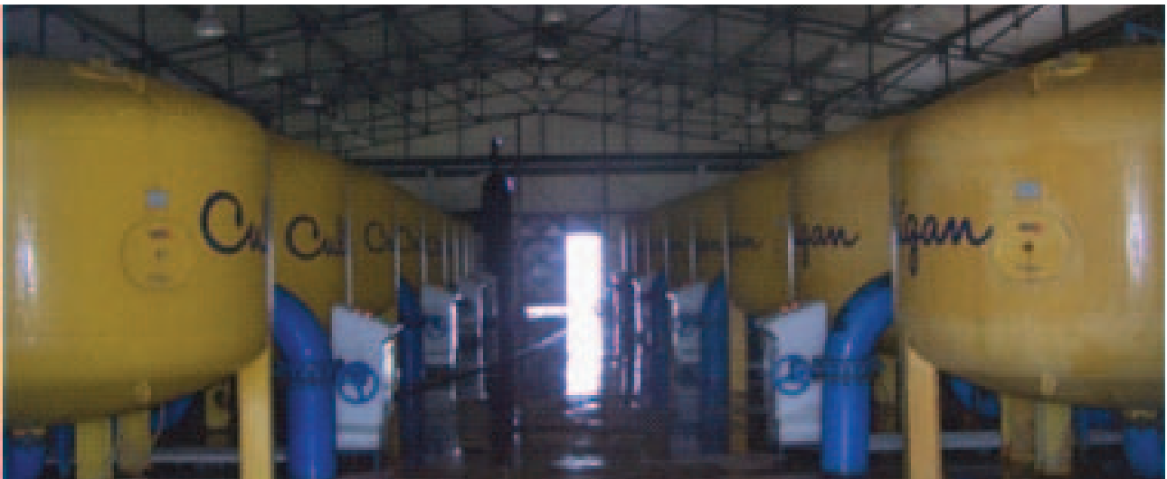
Maltepe İçmesuyu Arıtma Tesisi Filtre Tankları
