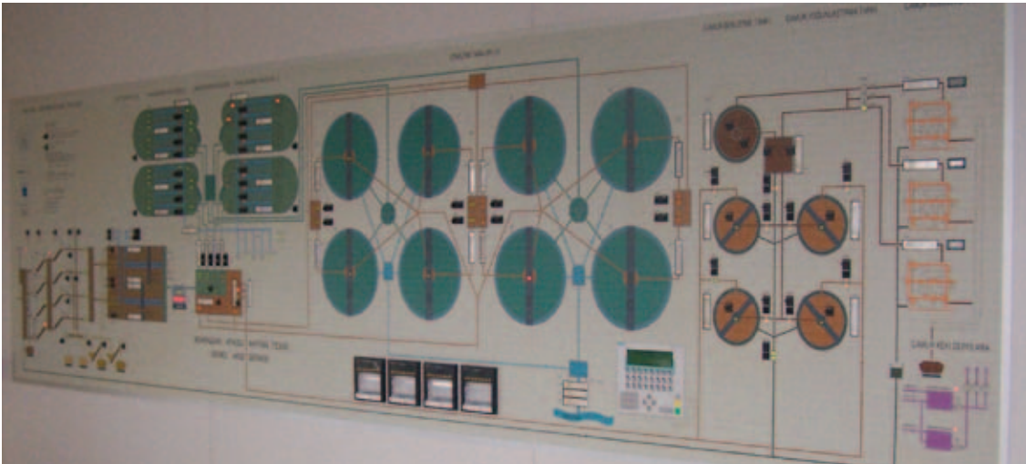
Karaman Atıksu Aritma Tesisi PLC Panosu
