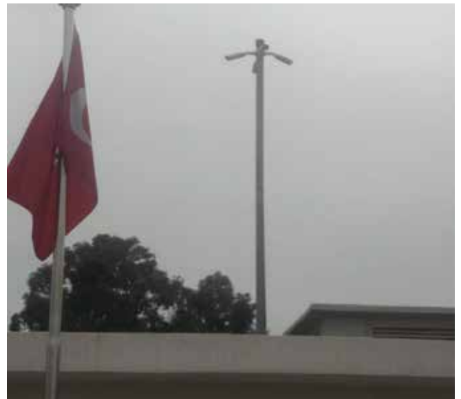
Montajı Yapılan Kamera Sistemleri
