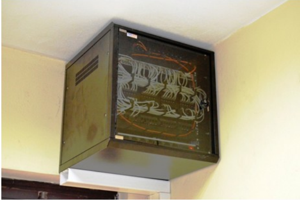
Yeni takılan Patch Paneller.
