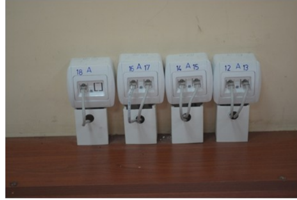
Duvara monte edilmiş bilgisayarlar arası iletişim prizleri.
