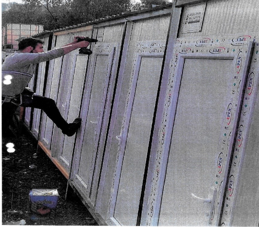
DEPREM BÖLGESİ 40 ADET KONTEYNER TUVALET ALIMI
