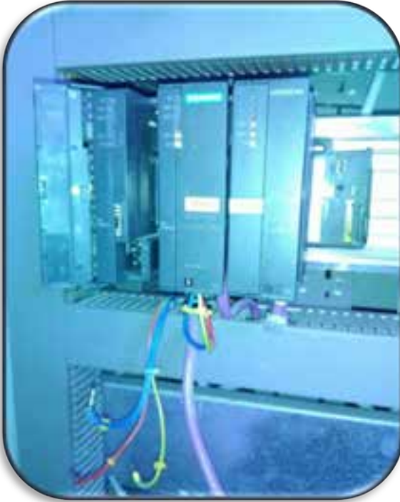
Atıksu Arıtma Tesisi PLC Haberleşme kartları değiştirildi.
