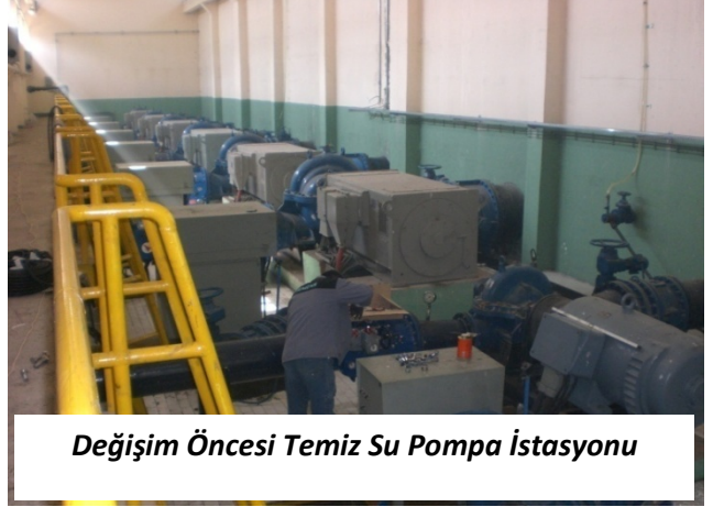
Değişim Öncesi Temiz Su Pompa İstasyonu
