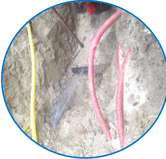
Şirinevlerde Su Hattı Üstünde Bulunan Doğalgaz ve Elektrik Hatları
