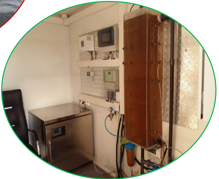
Atık Su Uzaktan İzleme Sistemi
