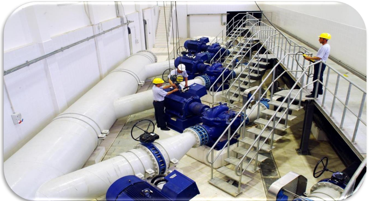
Çatalan Arıtma Tesisi Pompa Odası
