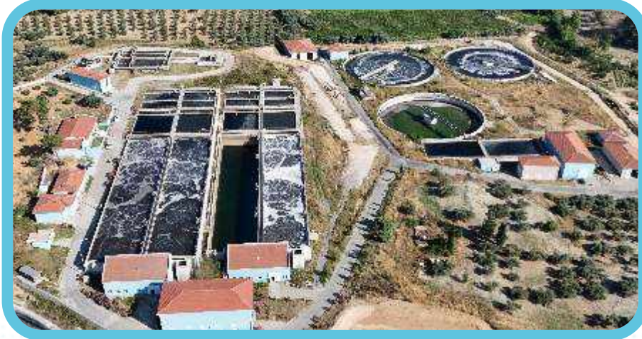
Kuşadası İleri Biyolojik Arıtma Tesisi
