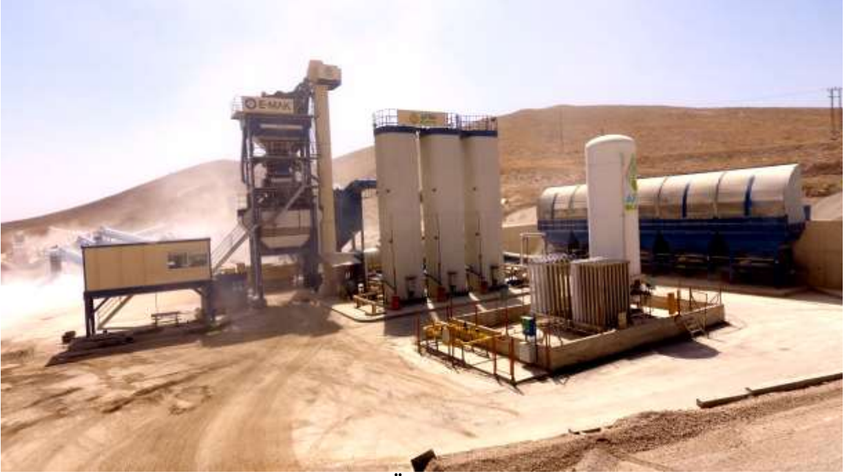
-Afşin'e Kazandırdığımız 160 Ton Üretim Kapasitesine Sahip Asfalt Plenti-
