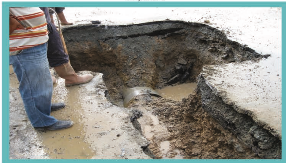
Resim:4 İçme Suyu Açb Boru Arızası
