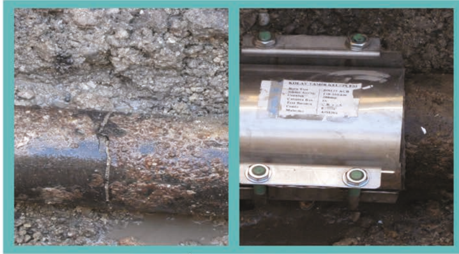
Resim:5 İçme Suyu Pik Boru Arızası
