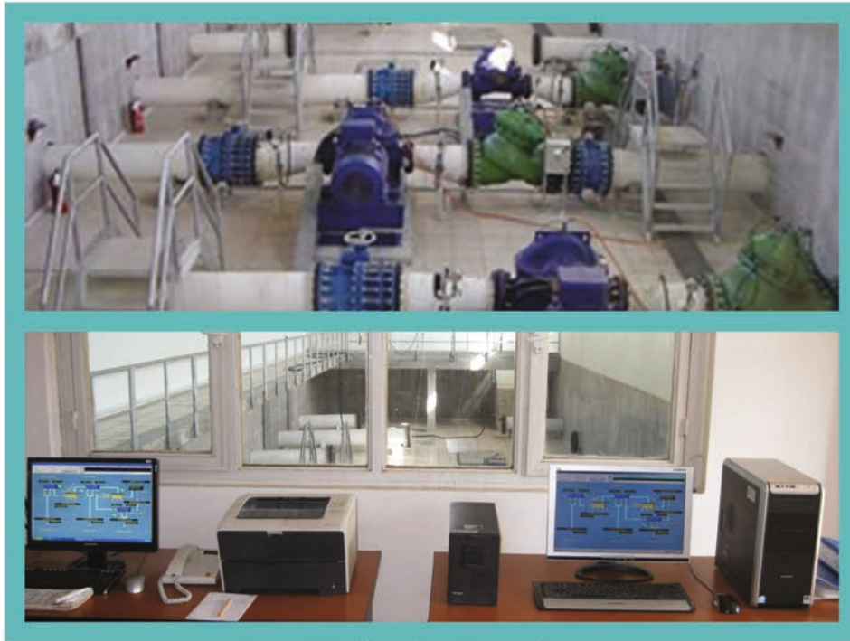
Resim No3: İçme Suyu Pompa İstasyonu
