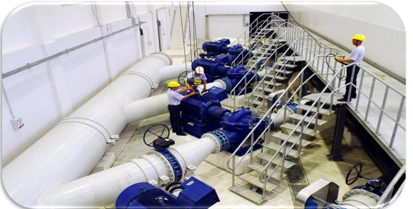
Çatalan Arıtma Tesisi Pompa Odası
