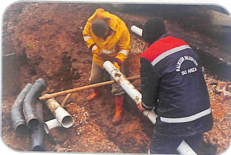
Ana Su Şebekesi PVC Boru Arızası
