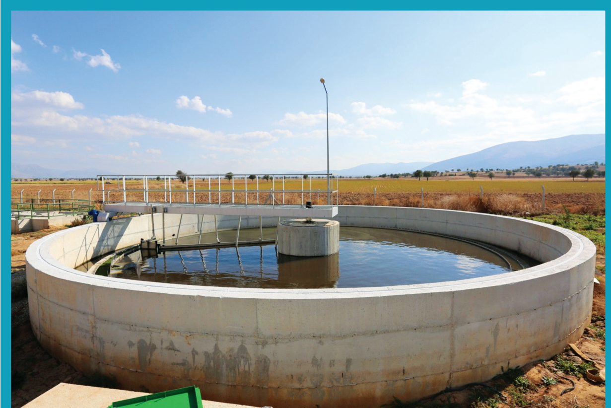
Serinhisar Atıksu Arıtma Tesisi
