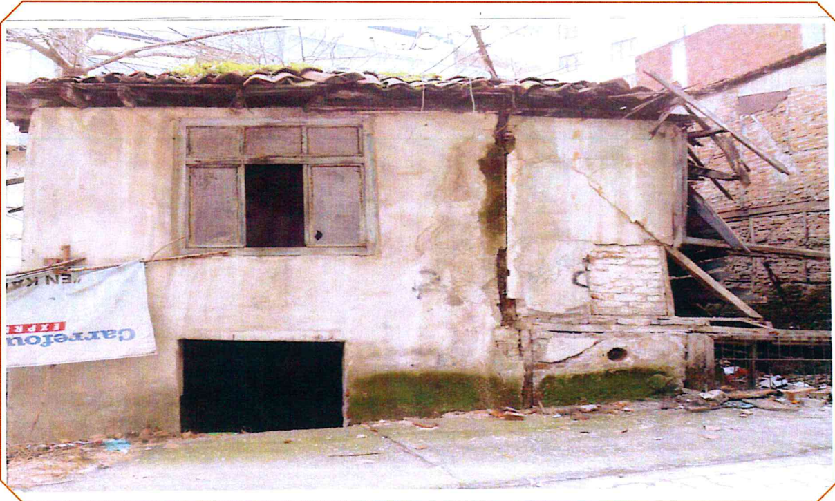
Fatih mahallesi Maili inhidam Kararı ile yıkımı gerçekleştirilmiş bina
