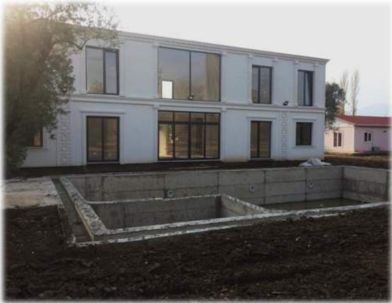
Kaçak Yapı Örneği, Yeniköy 4672 Parsel
