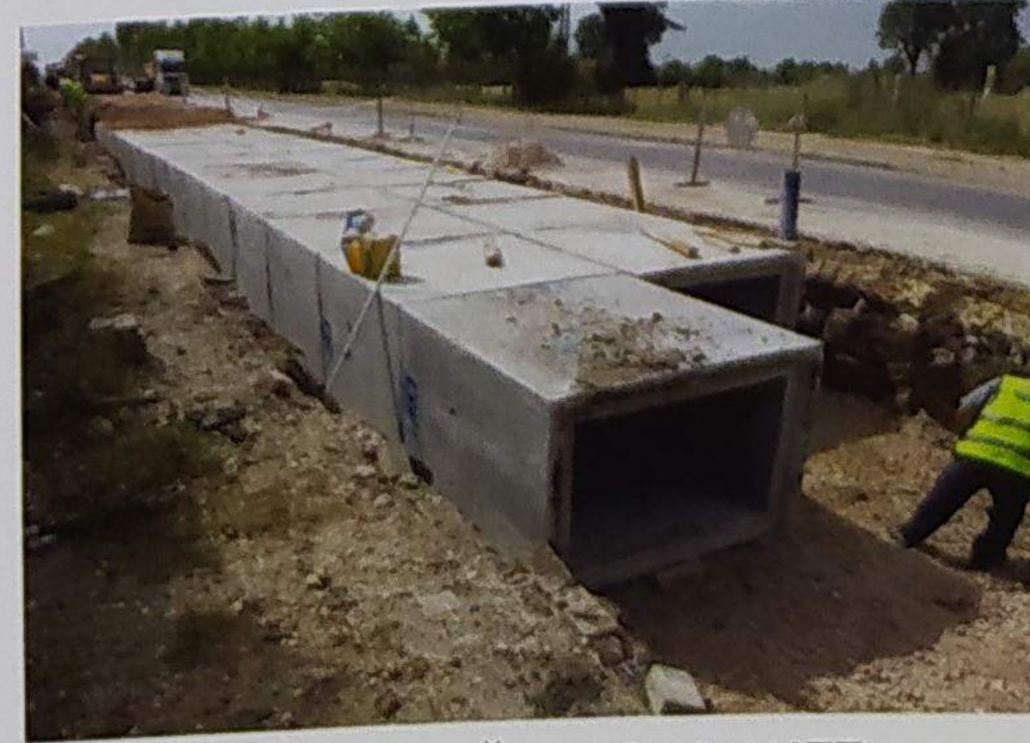
GÖL YOLU YAĞMUR SUYU HATTI
