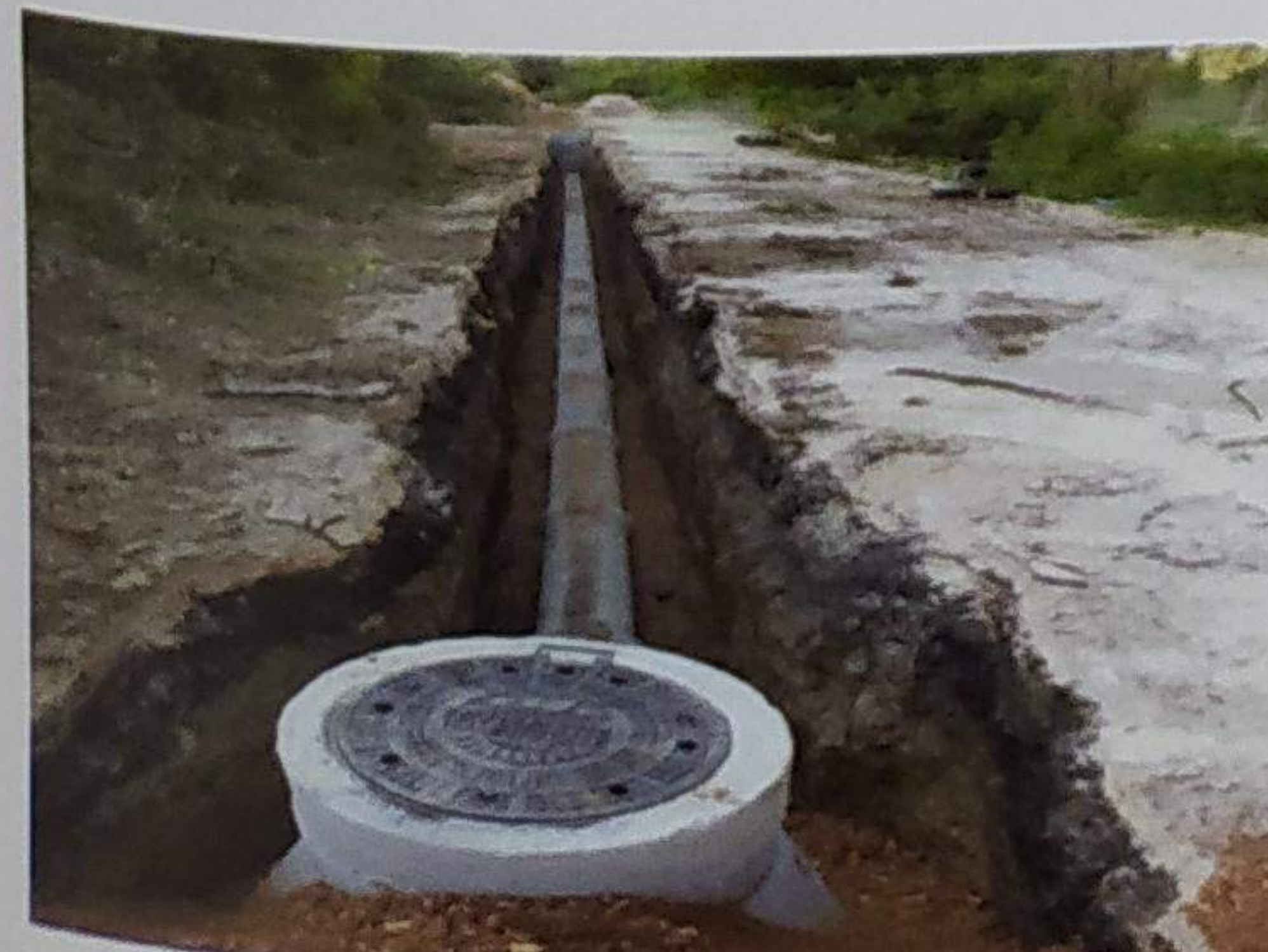
GÖL YOLU YAĞMUR SUYU HATTI
