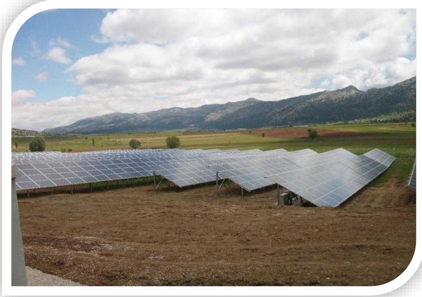
Foto 2. Güneş Enerji Santrali
