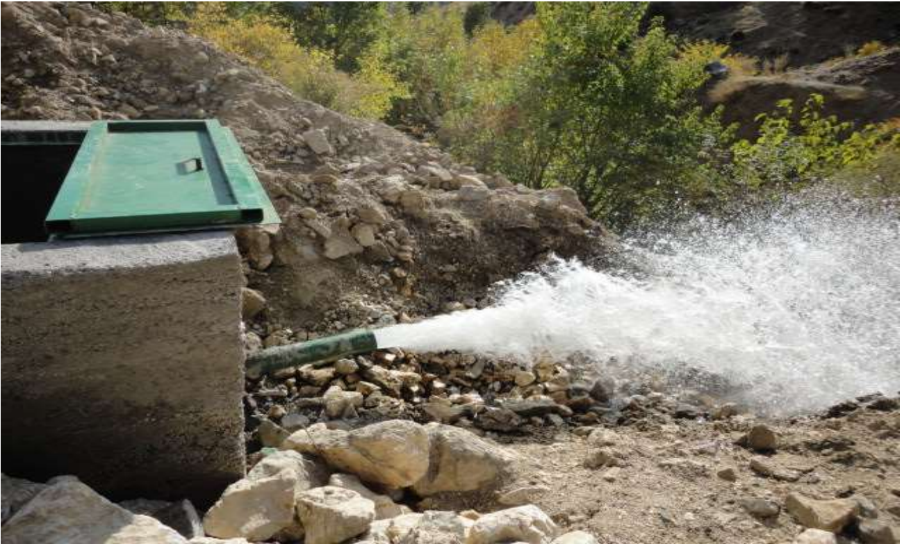
Çelikhan Recep Köyü Şahverdi Mezrası Tarımsal Sulama Tesisi
