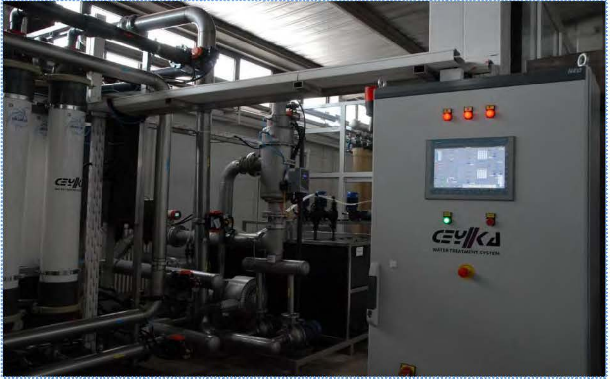
Filtre SCADA Panosu
