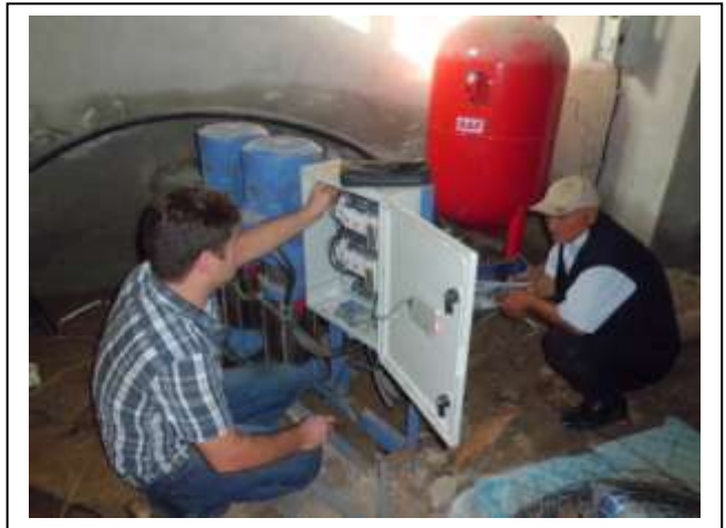
Koçkiran köyü arıza tespit çalışması
