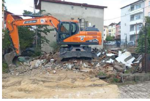
Metruk Bina Fotoğrafi
