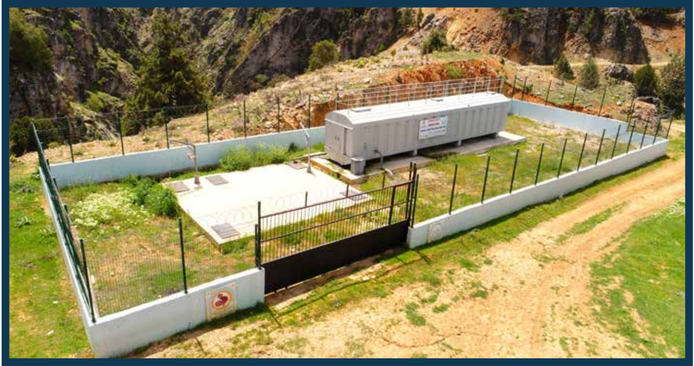
Acıpayam-Eskiköy Paket Atıksu Arıtma Tesisi
