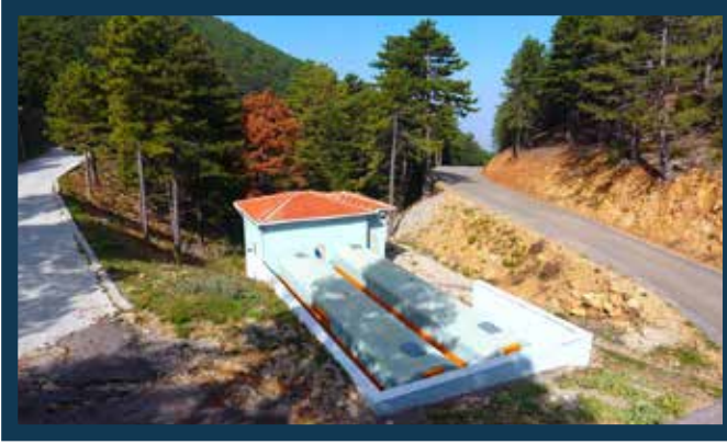
Bağbaşı - Zeytinyayla Paket Atıksu Arıtma Tesisi
