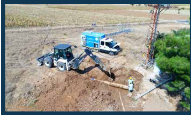
Serinhisar İlçesi İçmesuyu Terfi Hattı Arızası
