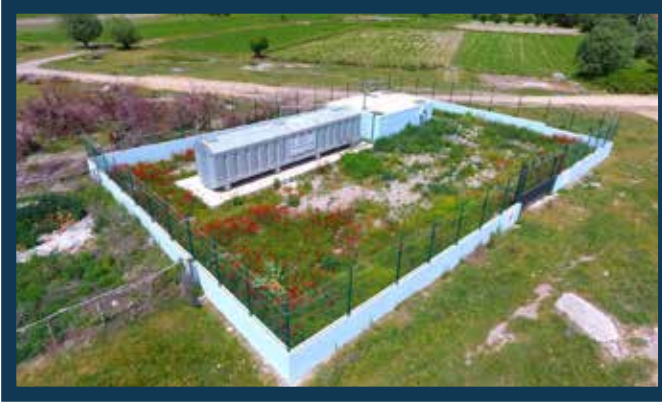
Çivril - Beydilli Paket Atıksu Arıtma Tesisi
