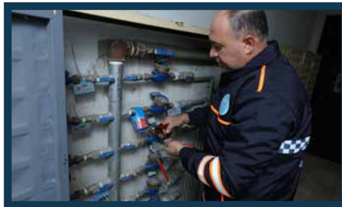
Tesisat Kontrolü ve Mühürleme İşlemi
