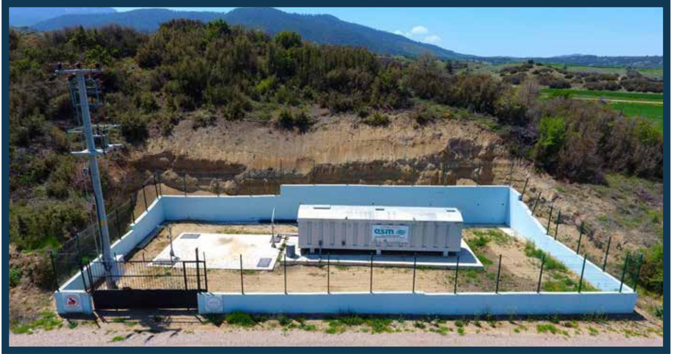
Bozkurt-Çambaşı Paket Atıksu Arıtma Tesisi
