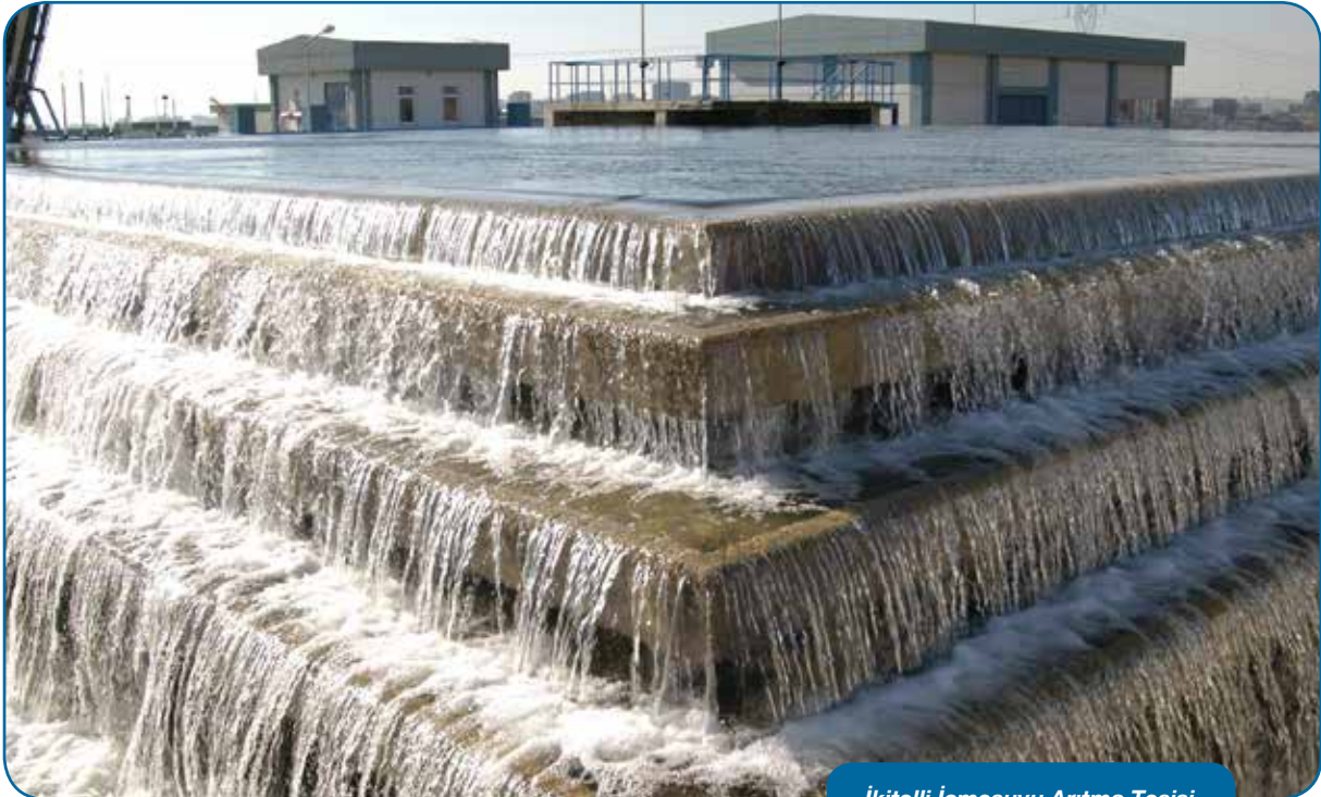
İkitelli İçmesuyu Arıtma Tesisi
