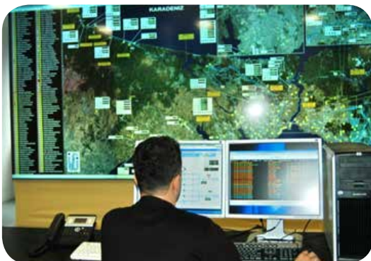
SCADA Merkezi Kontrol ve Operatör Ekranları
