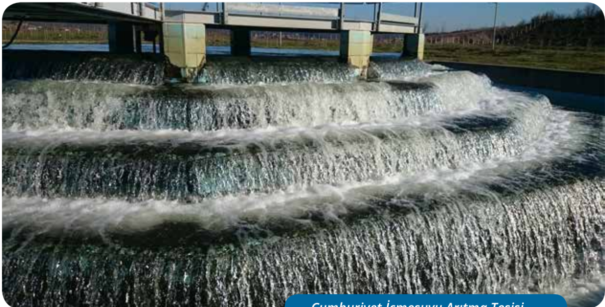
Cumhuriyet İçmesuyu Arıtma Tesisi
