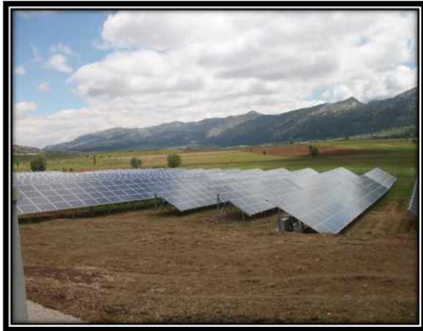
Foto-2: Güneş Enerji Santrali
