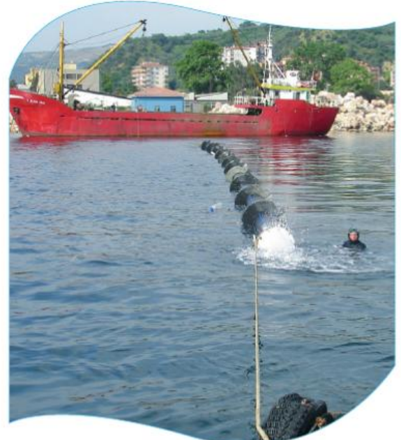
Mudanya Atıksu Ön Arıt. ve Derin Den. Deş. Tesisleri
