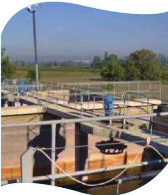
Çalı Atıksu Arıtma Tes.
