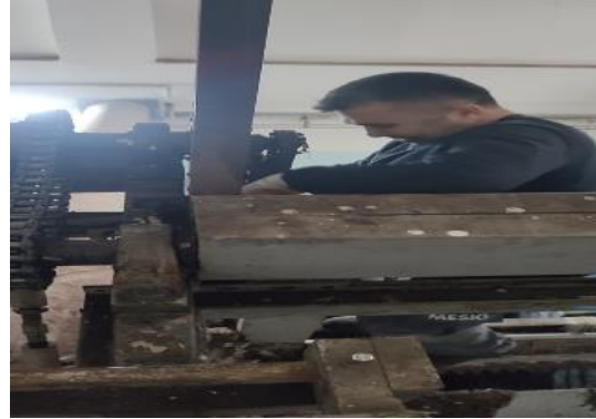
Atık Su Terfi İstasyonları mekanik Izgara tamir ve bakımları
