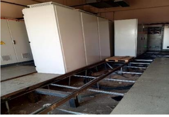
Viranşehir Atıksu Terfi İstasyonunda bulunan yetersiz güçteki frekans konvertörlerinin temini ve montajı (630 kw)
