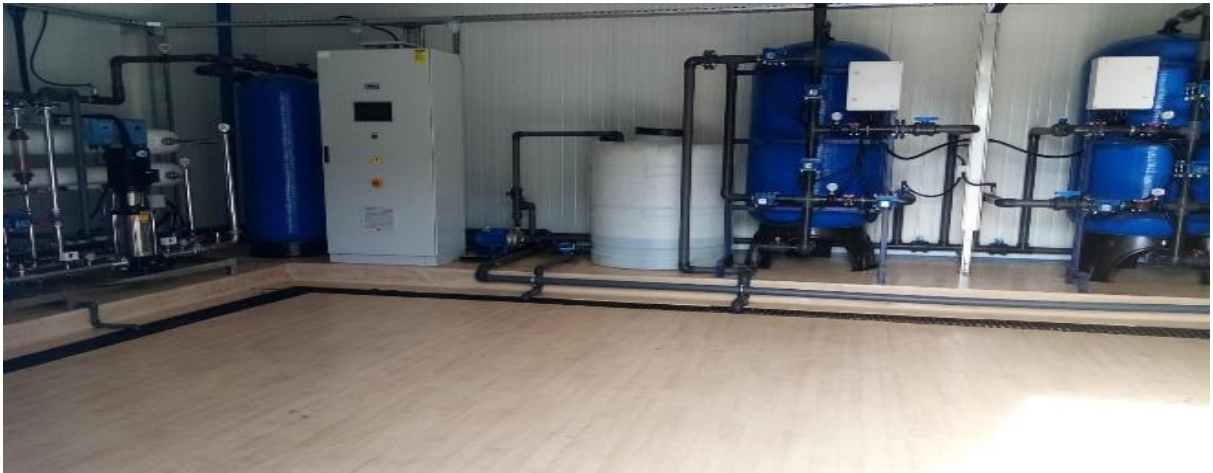
Tarsus İncirgediği Paket İçme Suyu Arıtma Tesisi
