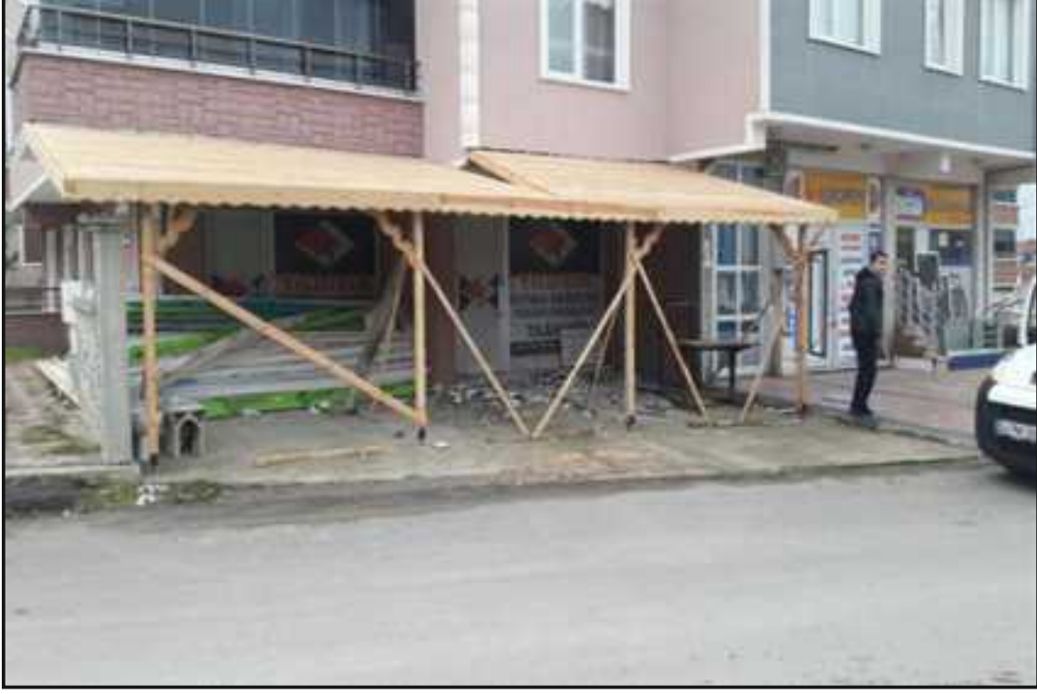
Resim 2 : İmara Aykırı Sundurma Yapımı
