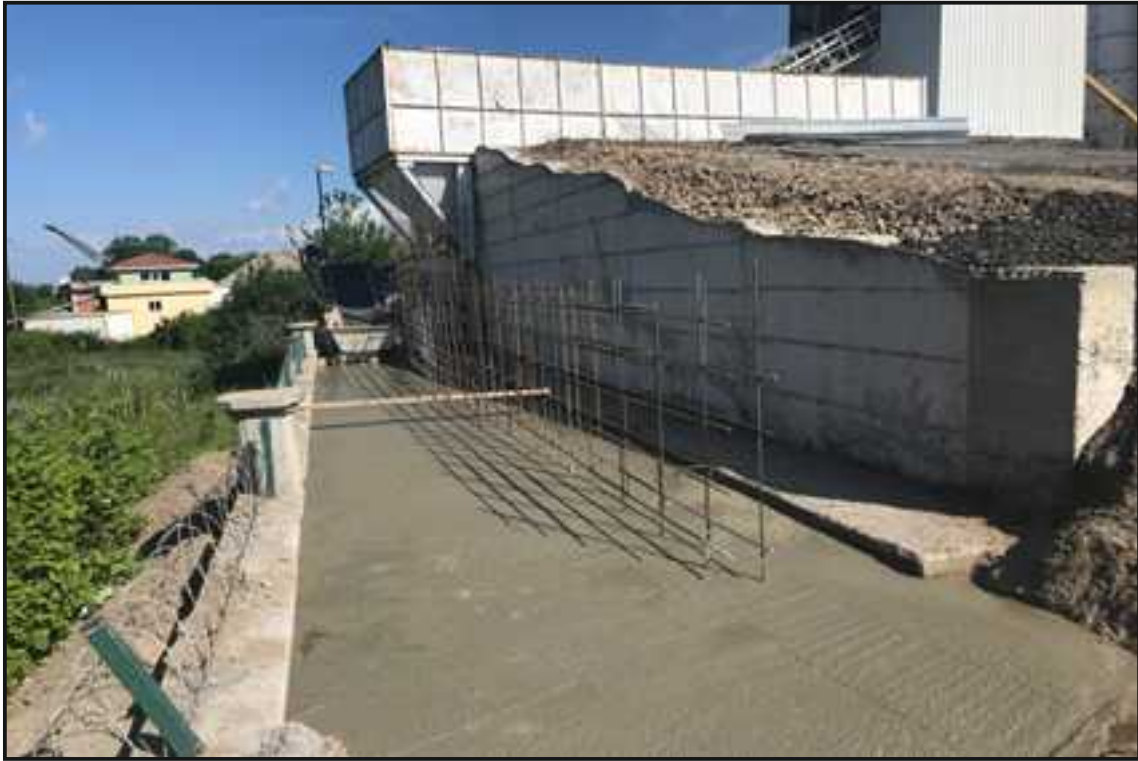
RESİM 4 : Şantiye Beton Santrali Rampa Perde Duvar
