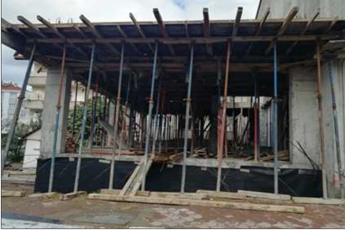
Resim 18: Ruhsatsız İnşaat Örneği
