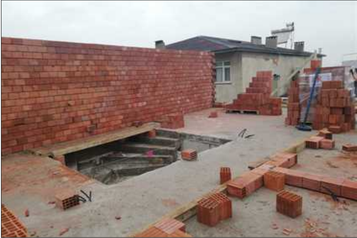
Resim 20: Ruhsatsız Yapı Örneği
