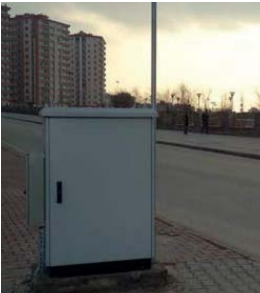
Şahintepe Mah. SCADA Ölçüm Noktası
