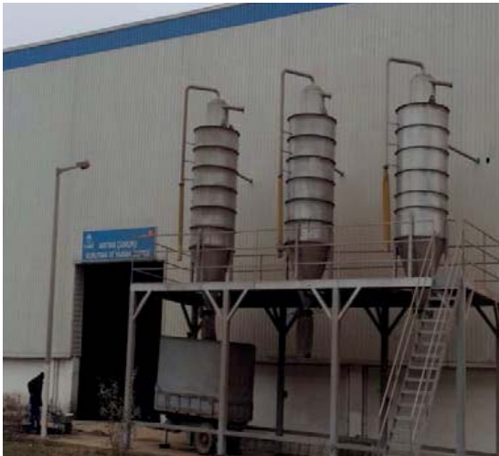
Arıtma Çamuru Kurutma ve Yakma Ünitesi
