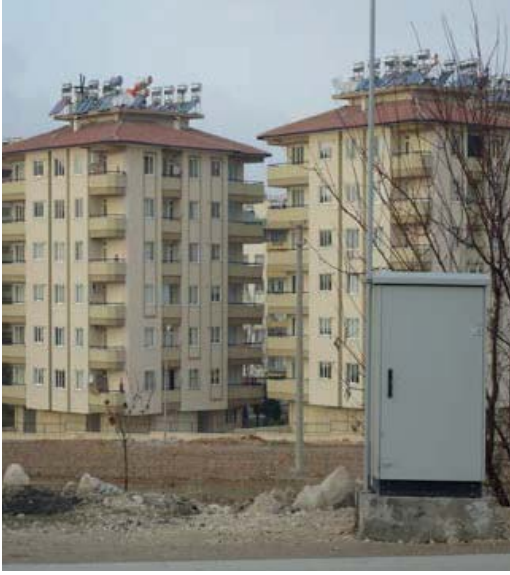
Karacaoğlan Mahallesi/İçmesuyu Şebekesi Kontrol Panosu
