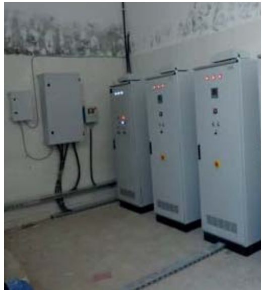
Devreye Alınan Oğuzeli Pompa İstasyonu
